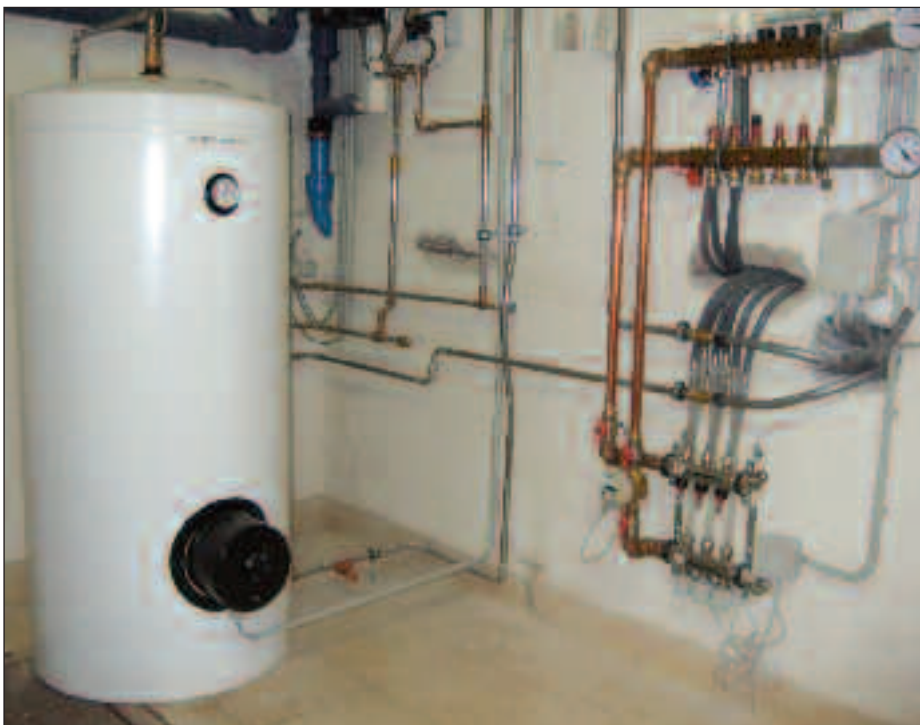
Neuer Heizraum im Gemeindehaus nach Fernwärmeanschluss
