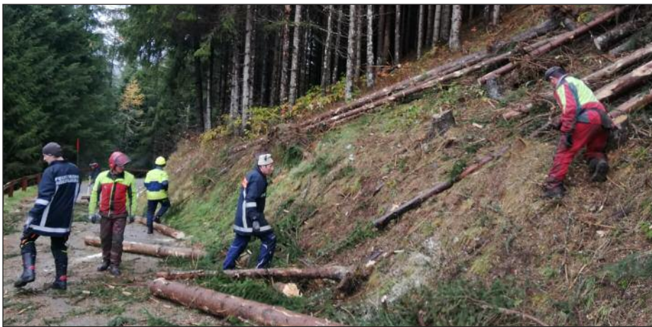
Aufräumarbeiten nach Sturmschäden
