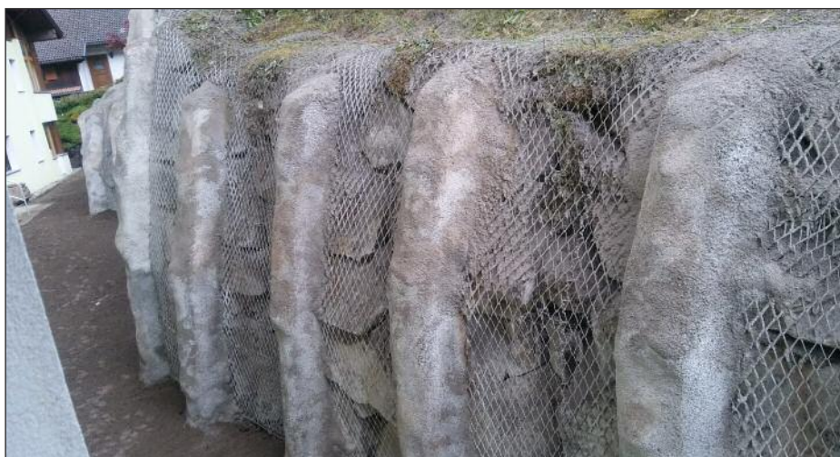
Sofortmaßnahmen aufgrund von Rissen und Hangbewegung
