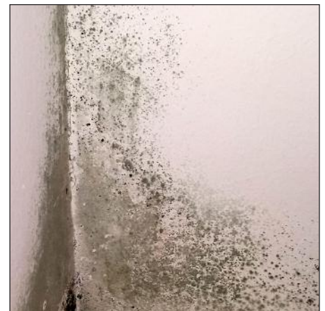
Schimmel an der Wand
