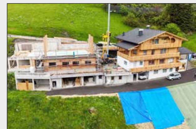
Hofmann Alois, HNr. 13 Abbruch und Neuerrichtung eines Wirtschaftsgebäudes sowie eines Wohnhauses mit zwei Wohneinheiten und einer Garconniere samt Carport
