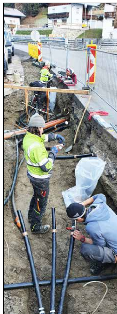
TINETZ-Verkabelung im Bereich Dorf
