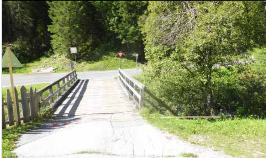
Altersschwache Rennlahnbrücke mit der sicherheitstechnisch ungünstigen Einbindung in die Villgratentalstraße
