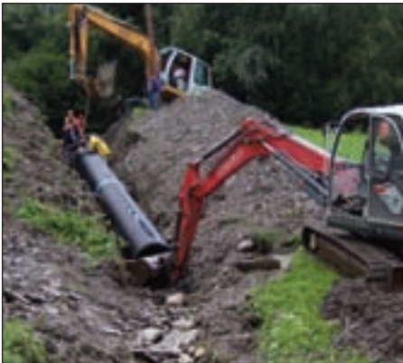
Rohrverstopfung durch Mure beim Mühlbachl in Unterwalden
